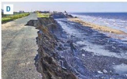
D Eroziune creată de apa mării
